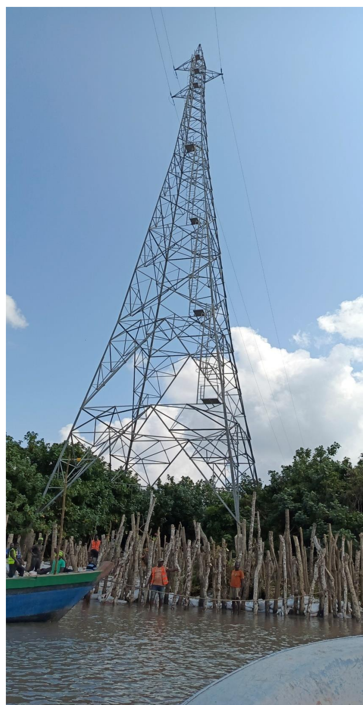
Legenda: Torre em eminência que actualmente esta sendo intervencionada na localidade de Mucundaia, Chinde
